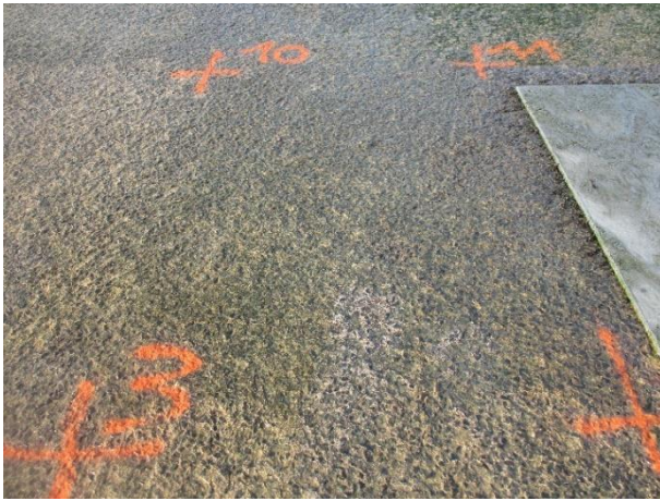
Photo n°40 : Nettoyeur haute pression le 2 novembre 2021 (bloc C) Note de 2
