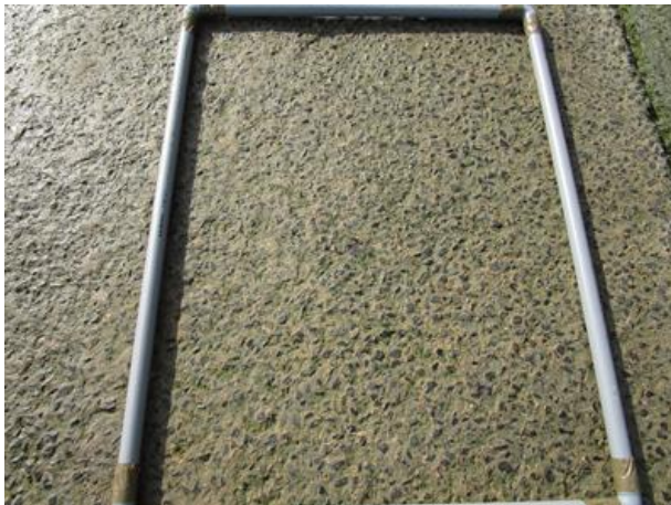
Photo n°19 : Bloc C4 (eau chaude seule) le 11/10/2021
