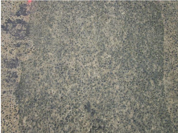
Photo n°21 : Aspect grisâtre après le passage de la brosse
